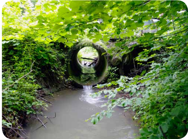
Przepusty rurowe czy okularowe to z zasady przeszkody nie do pokonania przez ryby
